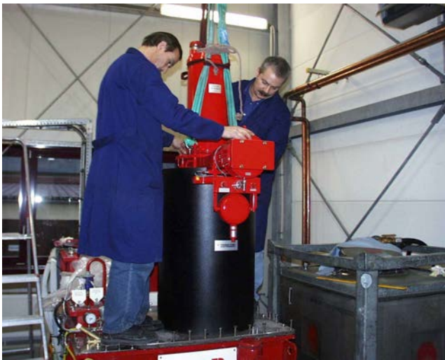
Abbildung 99: Installation eines 5 MW Klystrons für PITZ.
