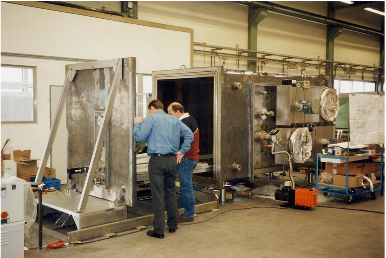
Abbildung 120: EB-Schweißanlage, Aufbau der Arbeitskammer.
